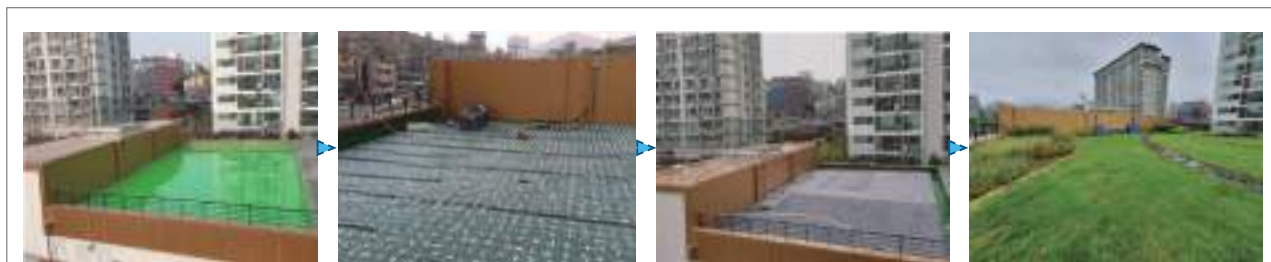
① 방수방근 (우레탄, 도막, 시트 선택) ② 빗물저금통과 물공급 호스 설치 ③ 수분유지 보온덮개 설치 ④ 토사 포설 후 잔디 및 식물 식재
